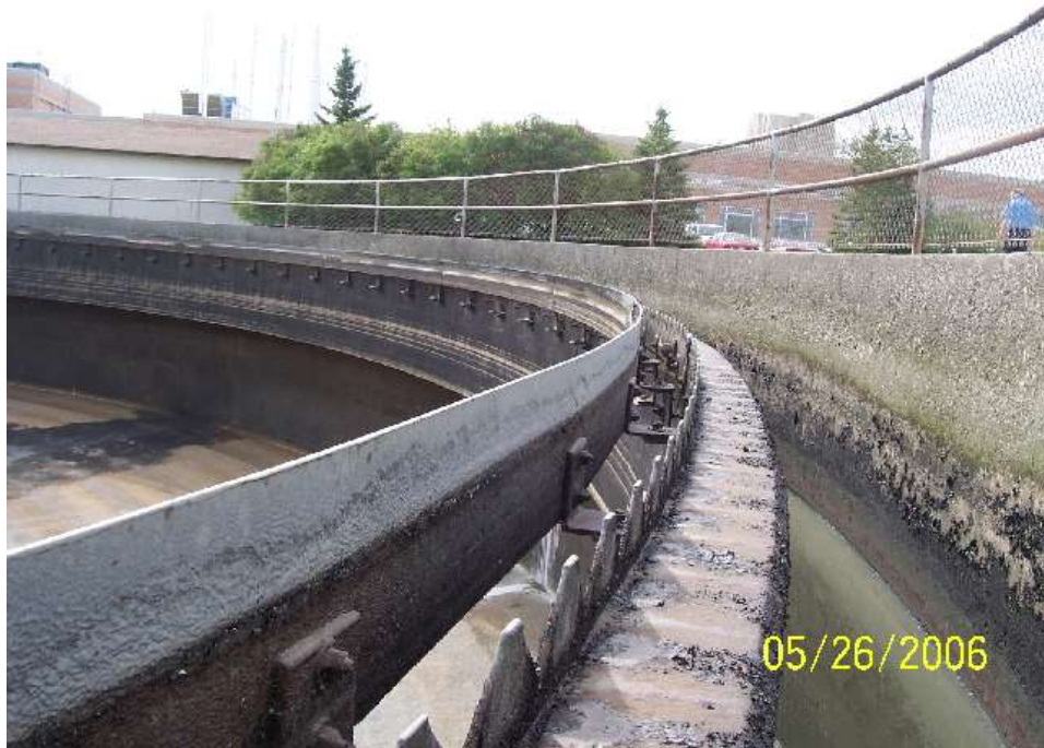
Photo 3-6 Effluent Weir & Launder
